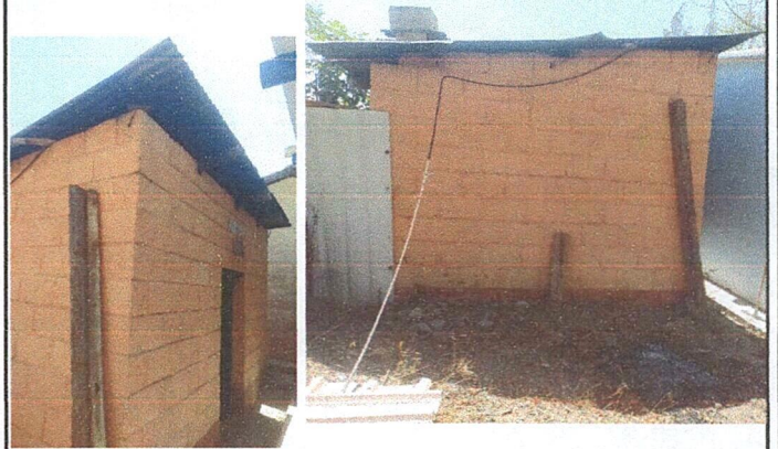
Foto 2: Remozamiento de cocina, con estufa de gas y de leña, chimenea, puerta, ventana estructura metálica, lámina troquelada calibre 26 y con piso de granito. Mejora de altura de las paredes, e instalación de energía eléctrica.
